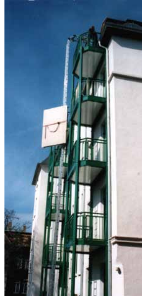
Le KS MAZ achemine les éléments de construction avec un encombrement réduit et jusqu'à une hauteur de 15 m
